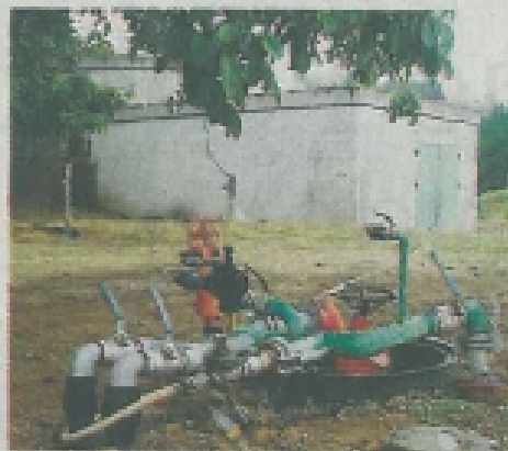
Les prises d'eau d'irrigation en complément des prises d'incendie. / Photo DDM J.-M. T.
